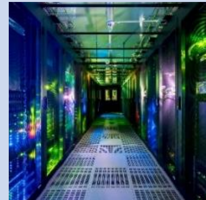
Green Datahub (data centres)
